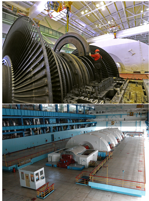
FIGURE 5.34 – Une des turbines de la centrale nucléaire russe de Balakovo (puissance centrale approx. 1 GW), en maintenance (haut) et en installation (bas).
