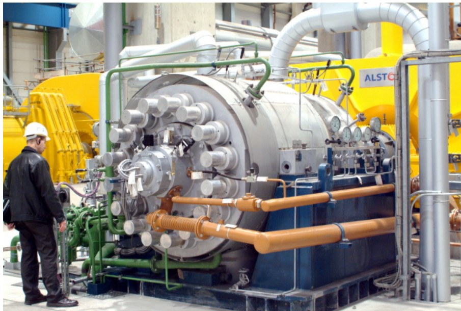
FIGURE 9.2 – Photo d’une pompe du fabricant KSB menant 2500 \text{ t h}^{-1} d’eau à 350 bar dans une centrale à vapeur.
